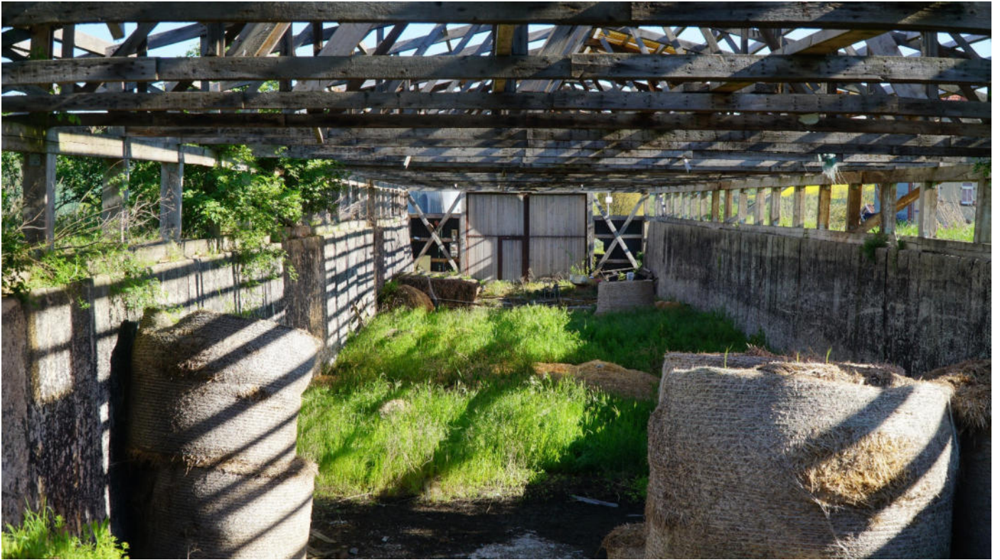
Innenansicht des Lagergebäudes mit fast vollständig fehlender Dacheindeckung
