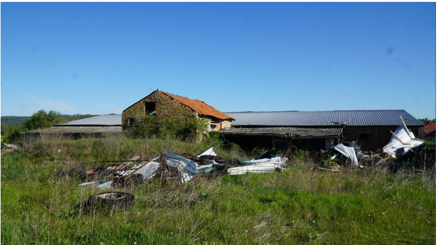
Stallgebäude Südansicht, die einschalige Eindeckung ist hier noch fast intakt
