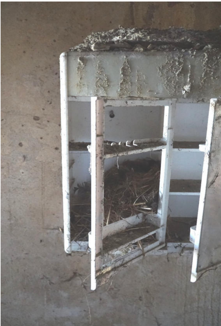
Brutstätte des Hausrotschwanzes aus dem Vorjahr in einem Sicherungskasten
